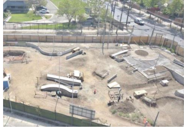
Imagen: Construcción skatepark en Avda. La Hacienda con Avda. El Carmen (Huechuraba)
